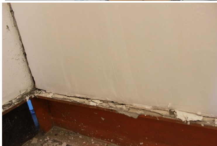
شکل (پ ۱-۲۵) بخشی از خرابی‌های مشاهده شده در دیوار شماره (۳)
