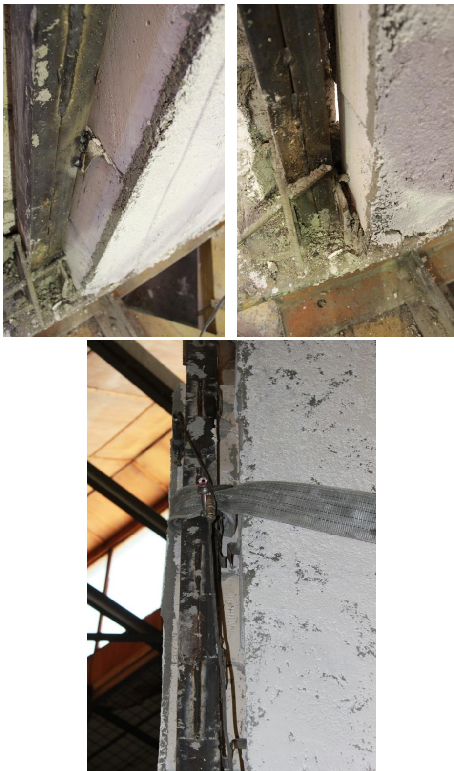
شکل (پ ۱-۲۴) بخشی از خرابی‌های مشاهده‌شده در اتصال دیوار شماره (۱) به قاب بر اثر رکورد نورث ریج
