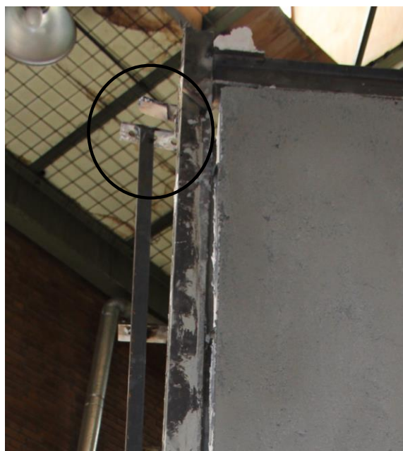
شکل (پ ۱-۲۳) فاصله بین قاب نگهدارنده دیوار (۳) و قاب سازه به همراه ورق افقی اتصال
